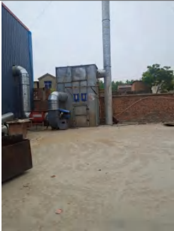
锯边、打磨废气处理设施（脉冲式布袋除尘）
