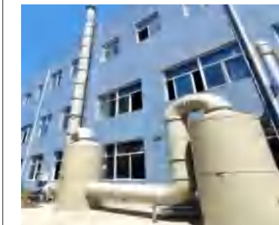
废料溶解废气处理设施
