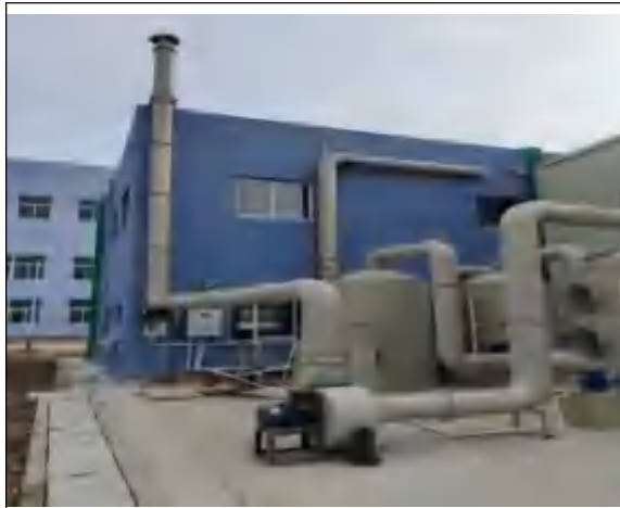
实验、化验废气处理设施
