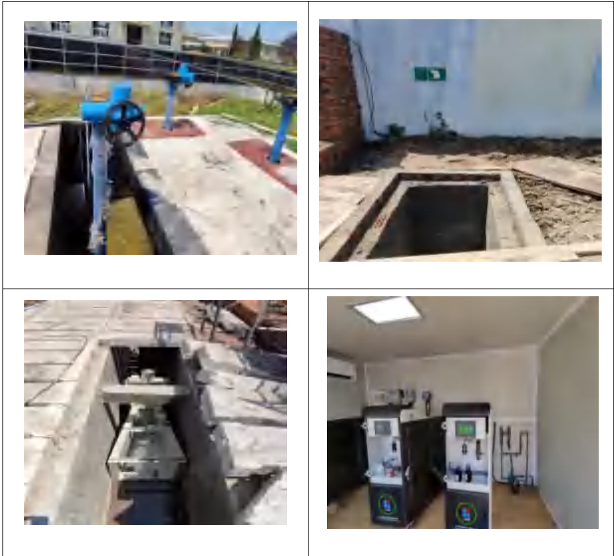
图 4.1-4 雨水在线监控及排口
