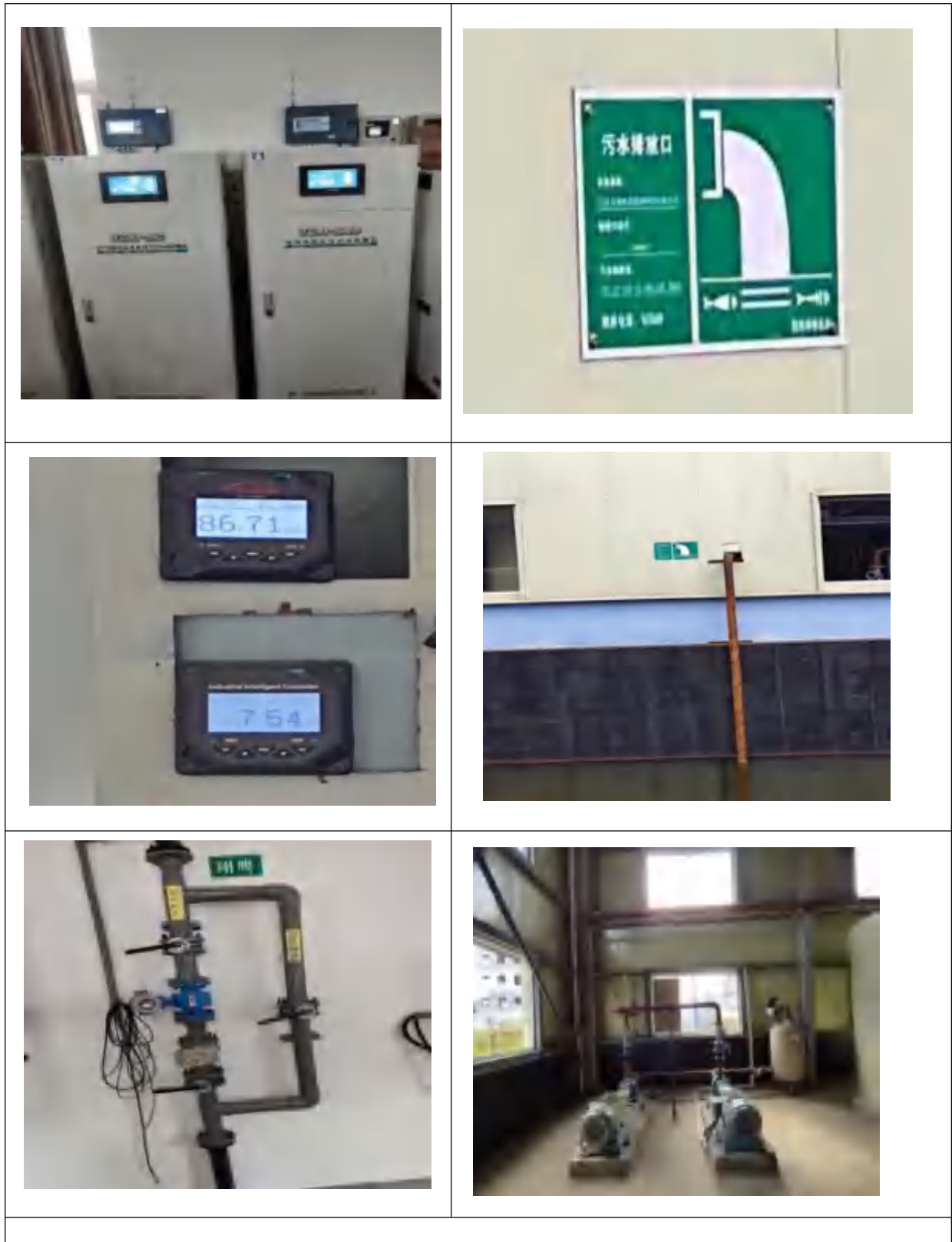
图 4.1-3 废水处理设施在线监控及排口
